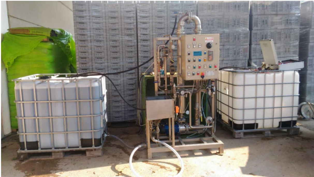
Abbildung 15: Ultrafiltrationsanlage – Angeli Idraulica (Foto: FEM)
